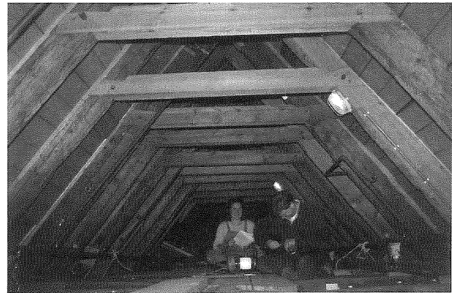
Afb. 2. Utrecht Janskerk, kapconstructie van dennen- en eikenhout (foto Dirk J. de Vries 1998)
